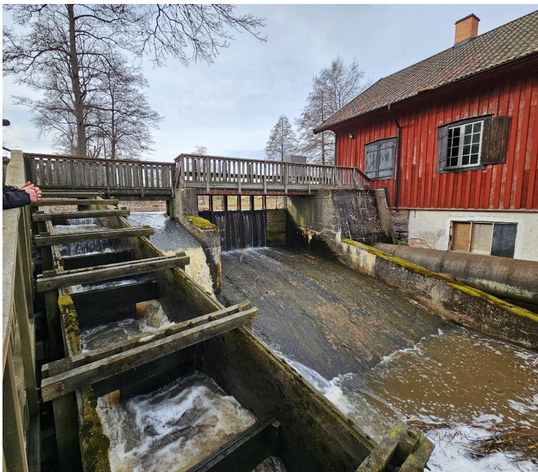
Figur 2 Befintlig kvarndamm med fisktrappa i förgrunden, luckor med bottenutskov och närmast kvarnbyggnaden turbinröret.
