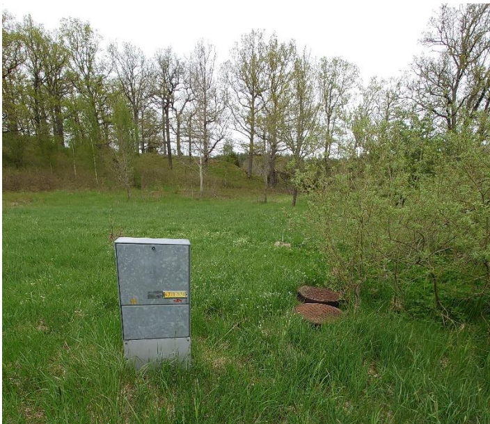
Elskåp och VA-brunnar mitt på ängen där det nordliga tomterna är planlagda.
