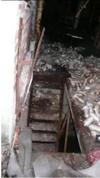
Figur 19. Källarplan är fylld med vatten. Runt trappan ligger en stor mängd rullar. Spärra av runt hela området, inklusive rullarna om dessa inte tagits bort innan provtagningsarbetet påbörjas.
