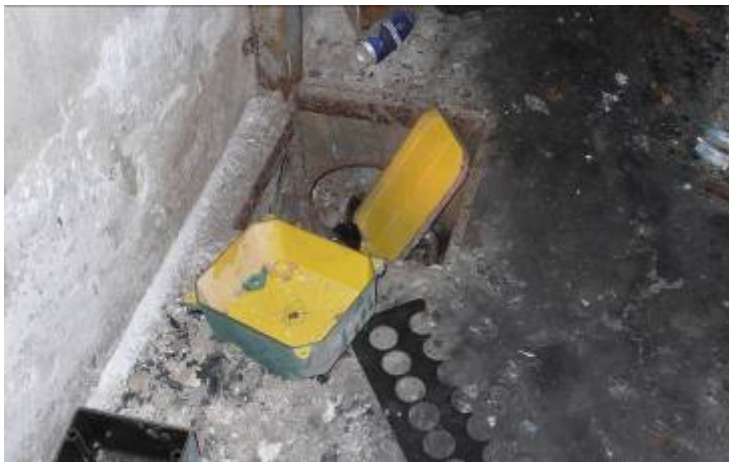
Figur 14. Hål efter infästningar och fundament kan vara svåra att se. Var uppmärksam!
