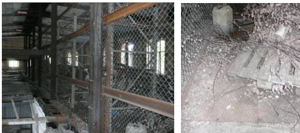
Figur 4. Stängsel i gott skick på övervåningen. Gångplåtarna har inte kunnat undersökas.
