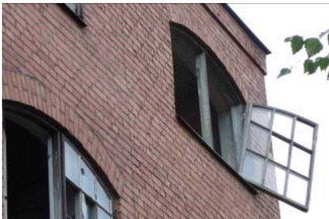
Figur 23. Fönster som står öppna och utsätts för väder och vind riskerar att falla ned om fasaden störs.
