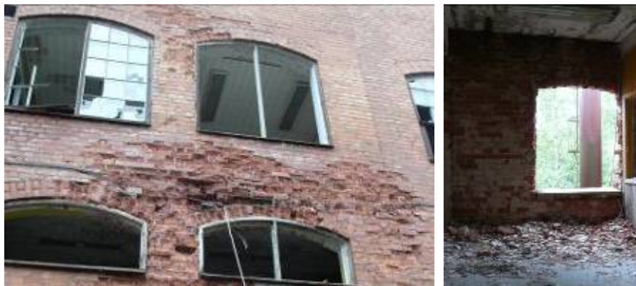
Figur 21. Tomma fönsteröppningar och omarkerade kanter utgör en risk för fallolycka och ska spärras av innan arbete påbörjas.
