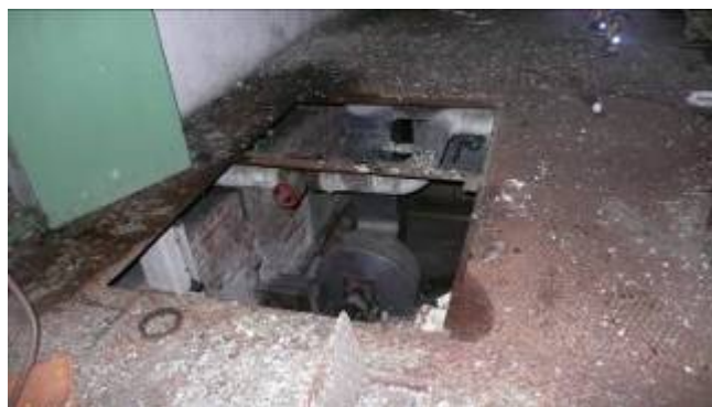
Figur 22. Hål i golv med hög fallhöjd (ned till nästa våning) är ofta omarkerade.
