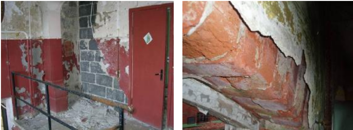
Figur 17 Flagad och målad puts på innervägg av lättbetong (vänster) och flagad och målad puts på innervägg av tegel (höger).
