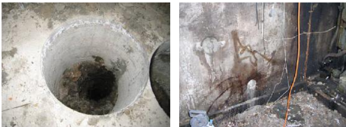
Figur 16 Ren betong i golvplatta (till vänster) och oljeskadar golv och vägg i värmecentralen (till höger).
