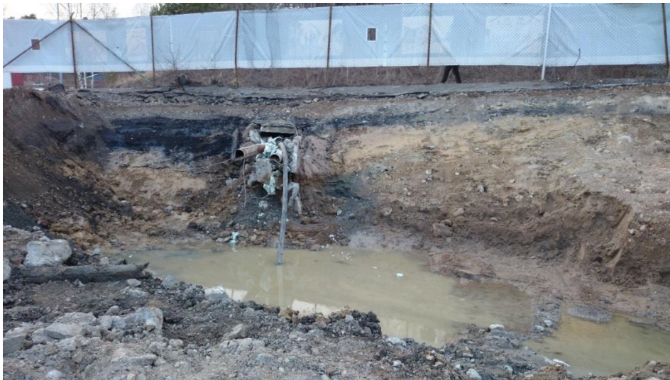
Figur 16 Område vid ruta 2:2 - 2:3, där kulvert med fjärrvärmerör från panncentral på andra sidan Bruksgatan kom fram. Större delen av oljeförorening bortschaktad. Grå jord till höger om kulvert sträcker sig in under vägen, men okulärt bedöms föroreningen härstamma från verksamhet Öster om vägen. Svartfärgade massor är "normala sotiga metallhaltig Gusumsmassor" utan olja. Förorenade massor i schaktvägg mot väg måste lämnas mot Bruksgatan av stabilitetsskäl
