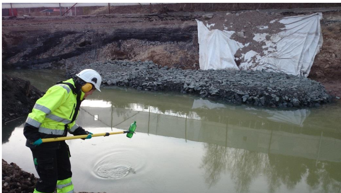
Figur 17 Samma område några dagar senare där vatten trängt in till ett djup mellan 0,2 – 0,8 m, motsvarar aktuell nivå i Gusumsån. Oljeskimmer syntes första dagarna på vattenytan men avtog efter ett par dag. Mängden stående vatten 0331 var ca 150 m 3 . Duk lades mot de förorenade massorna i schaktvägg, vilket påbörjats i bilde
