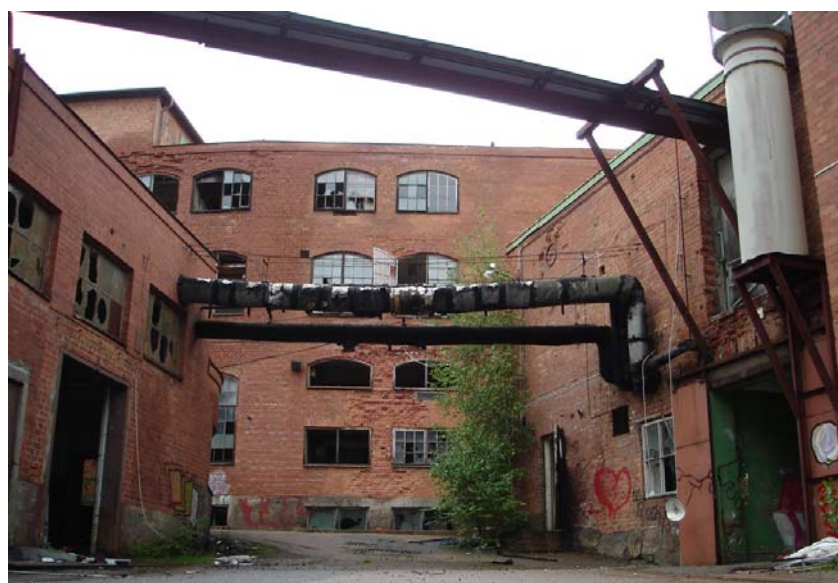
20 år av obefintligt underhåll och vandalisering har satt sina spår på huskropparna. Jämför med bilden på framsida som i princip föreställer samma vy, men drygt 50 år tidigare. Foto: AL 2006-08-27
