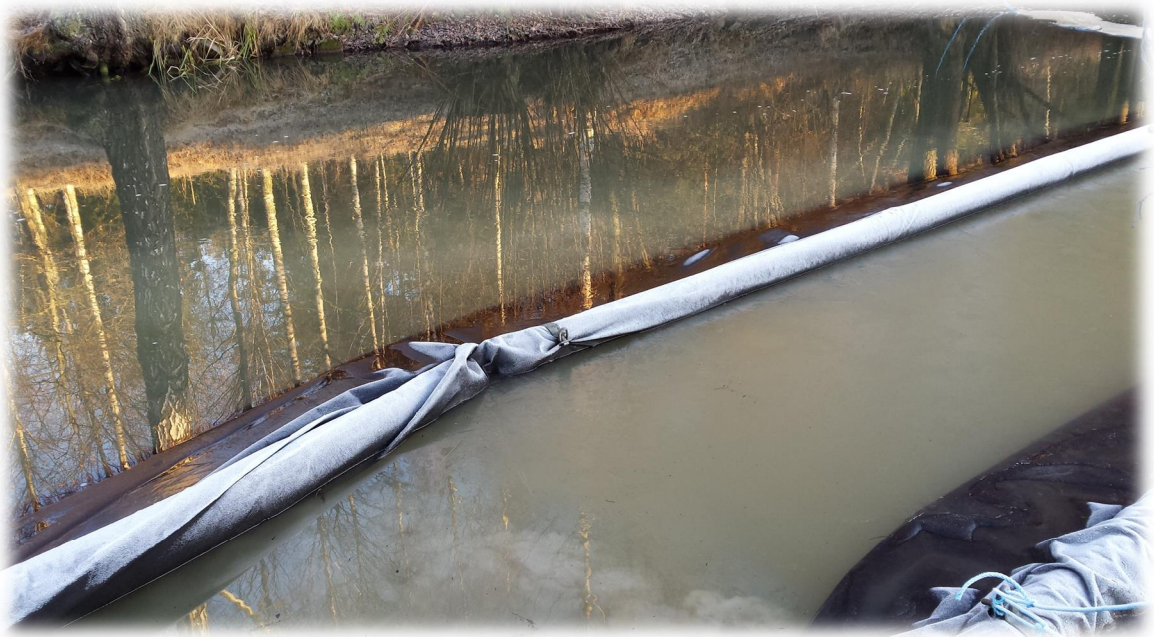
Bild 2 Synlig grumling mellan och utanför siltskärm 1 och 2, N slänten
