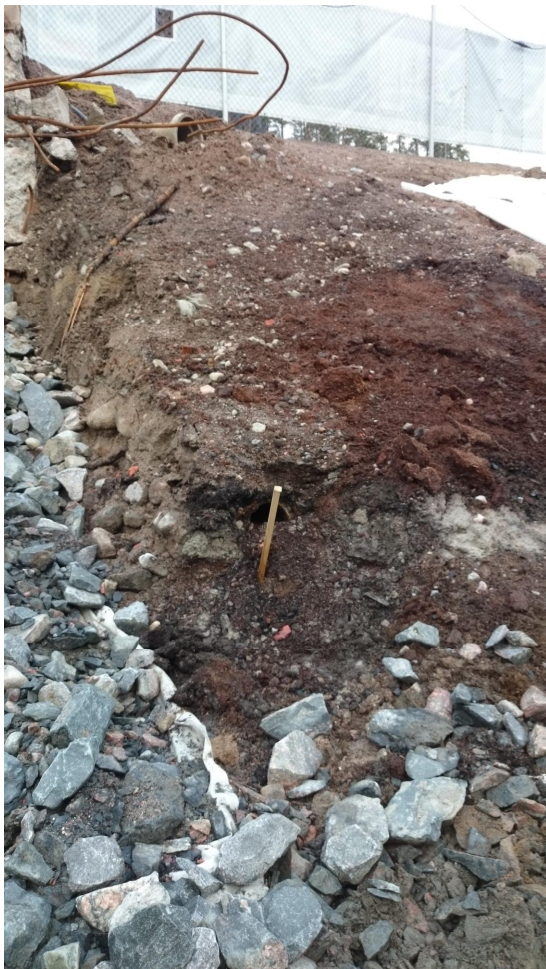
Avloppsrör i norra slänten som leds vidare till ån.
