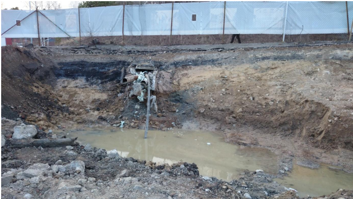
Schakt 2:2. Kulvert från panncentralen. Oljeförorening syns gråfärgad till höger om kulverten.
