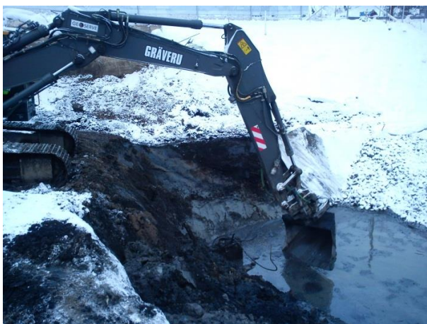
Bild 2. Tät lera syns i vägg mot Bruksvägen. Botten/slutprov, V:3/1:17/1:16.
