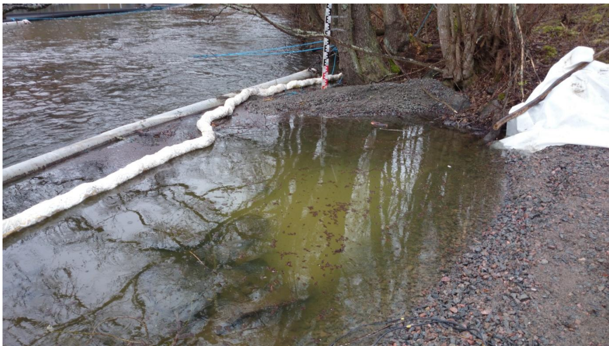
Djupare grop på östra sidan 1:36, ej färdigsedimenterad.
