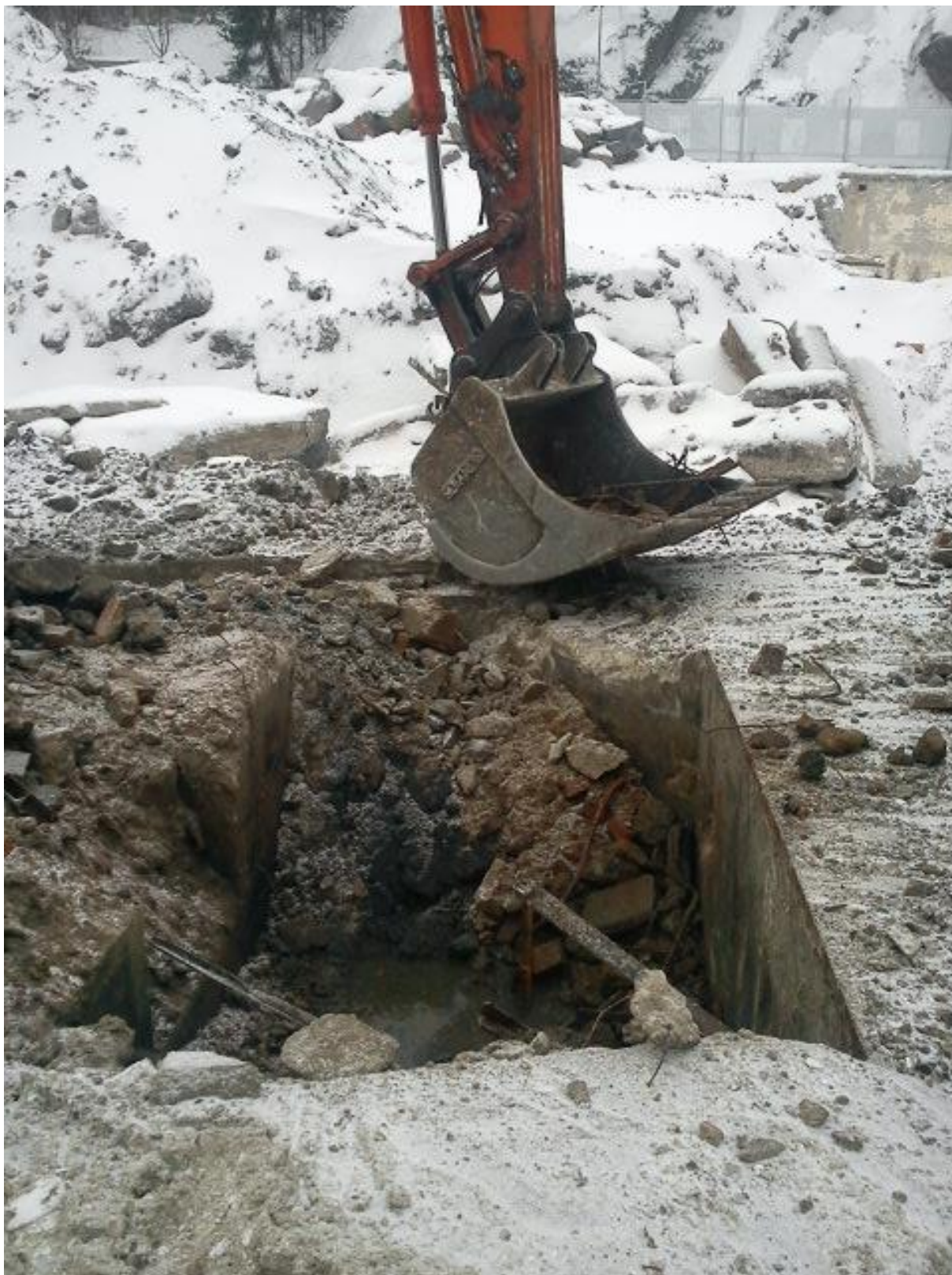
Bild 4. Hål i E1/E2 med oljehinna på vatten
