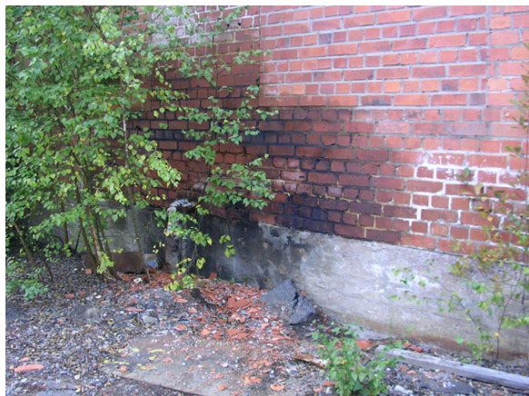
Bild 3. E103tg - oljeskadad vägg vid underjordisk tank 2008-09-02.
