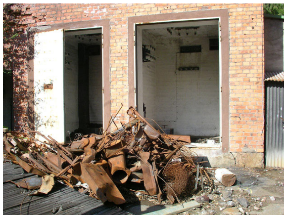
Bild 2. Hus B - plan 1 transformatorrum, 2008-09-02.
