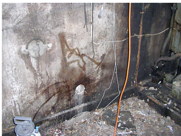
Bild 3. Hus V - V002btg, vid oljeskadad vägg, 2008-09-26.
