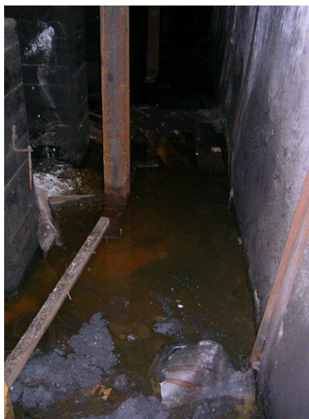
Bild 8. Hus B plan 1 - vattenfyllt mellan fundament och stenmur, 2008-09-02.
