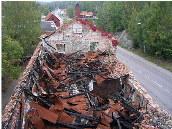
Bild 3. Hus F - det mesta har rasat ihop 2008-09-23.
